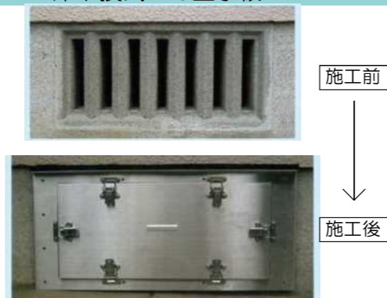
床下換気口の止水板
